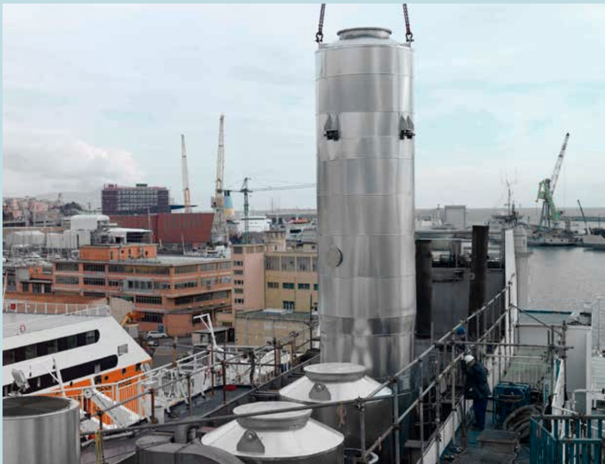
Marine DeSOx-System (Bild: Mit freundlicher Genehmigung von Ecospray Technologies)
